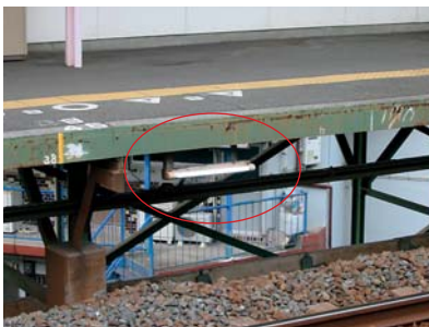
ホーム下LED照明
